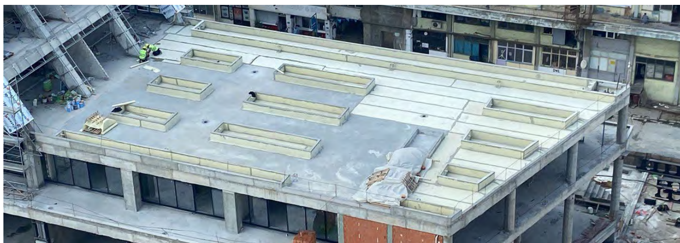
Impermeabilización de 20.000 m 2 de DRY120 en todas sus terrazas transitables exteriores. ISTMALL ESTAMBUL. Edificio para oficinas, universidad y centro comercial. Estambul. Turquía.
